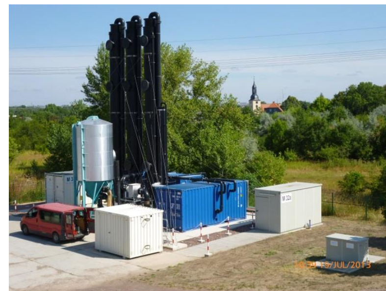
Grundwasserreinigungsanlage in Schkopau
